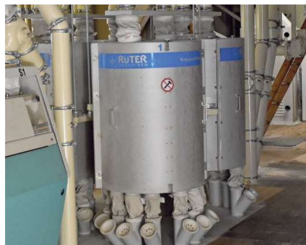
Die neu eingebaute «Sicher» sieben das Produkt.
